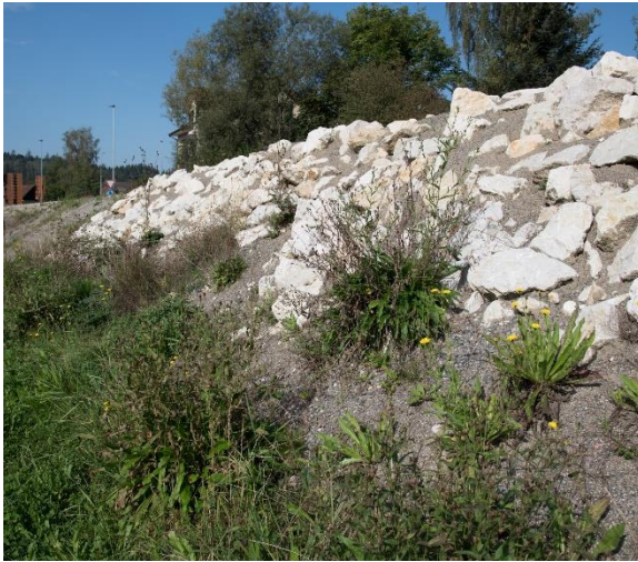
Abb.10: Strassenböschung mit Steinlinsen an der Zofingerstrasse*
